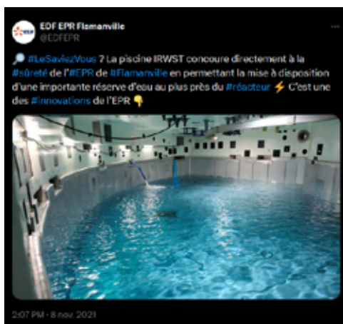
Piscine IRWST © EDF
